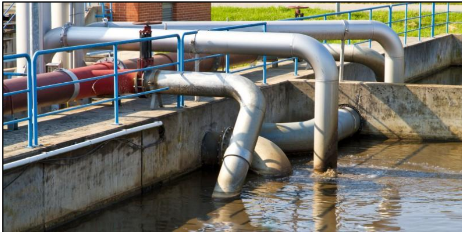
Foto 6. Energiegewinnung aus Klärschlamm im Klärwerk von Renningen in Deutschland (Quelle: Jürgen Fälchle / Fotolia.com) 11 .
